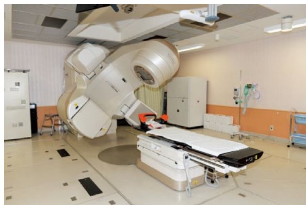
定位放射線治療が可能な直線加速器 TrueBeam®
